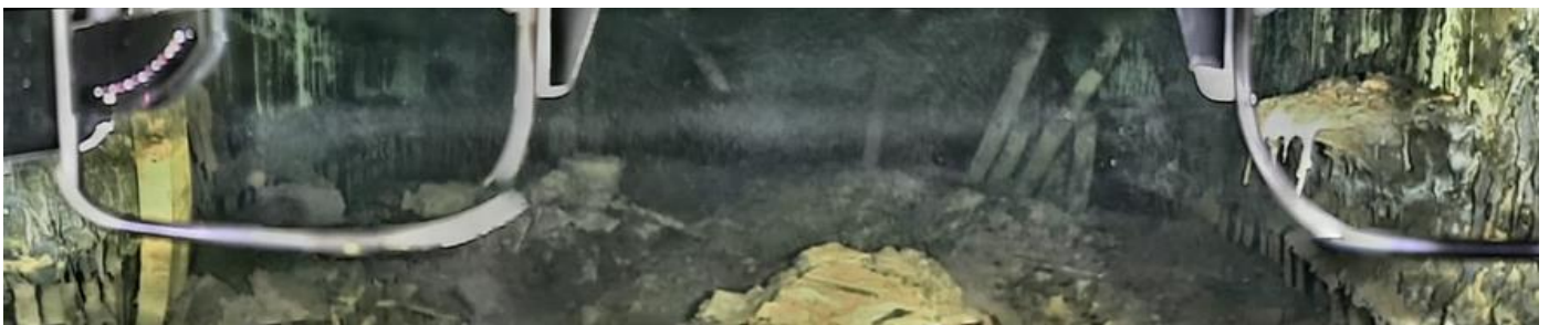
写真：1号機圧力容器の土台の惨状（IRID 提供）
